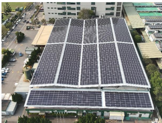
新竹產業園區廠房993.0KW
