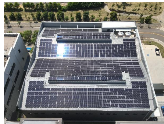
新竹鳳山工業區廠房223.47kw
